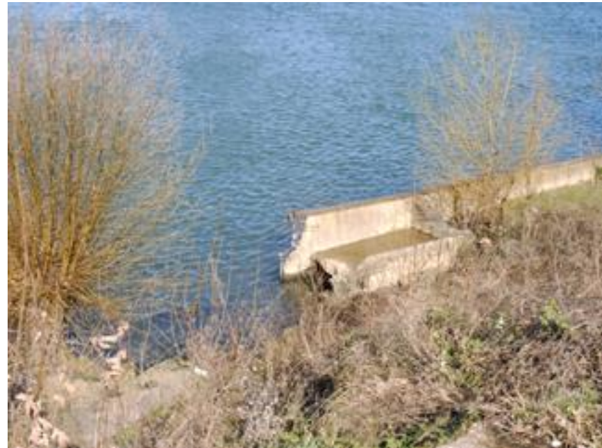
(9) fév2008 élément de démolition déposé sans ancrage !
